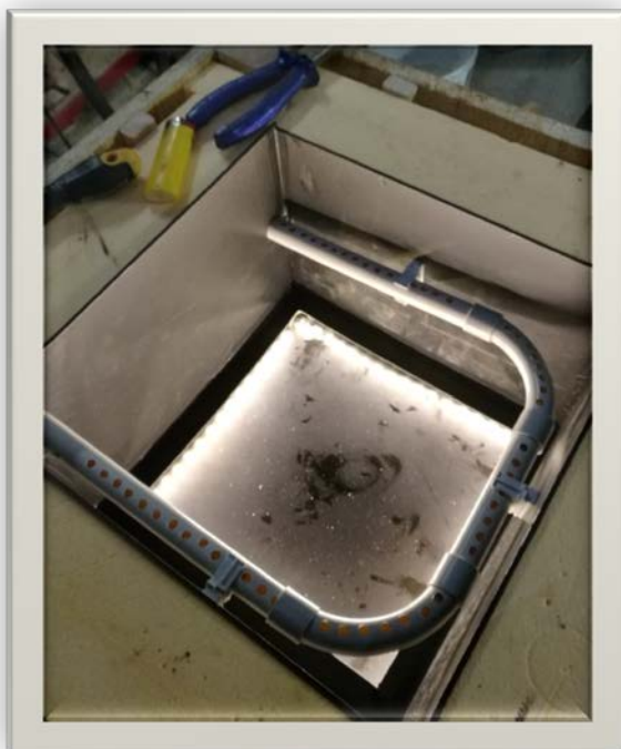
Bild 8): Kammer mit fertiger Beleuchtung und Sichtschutzblende
